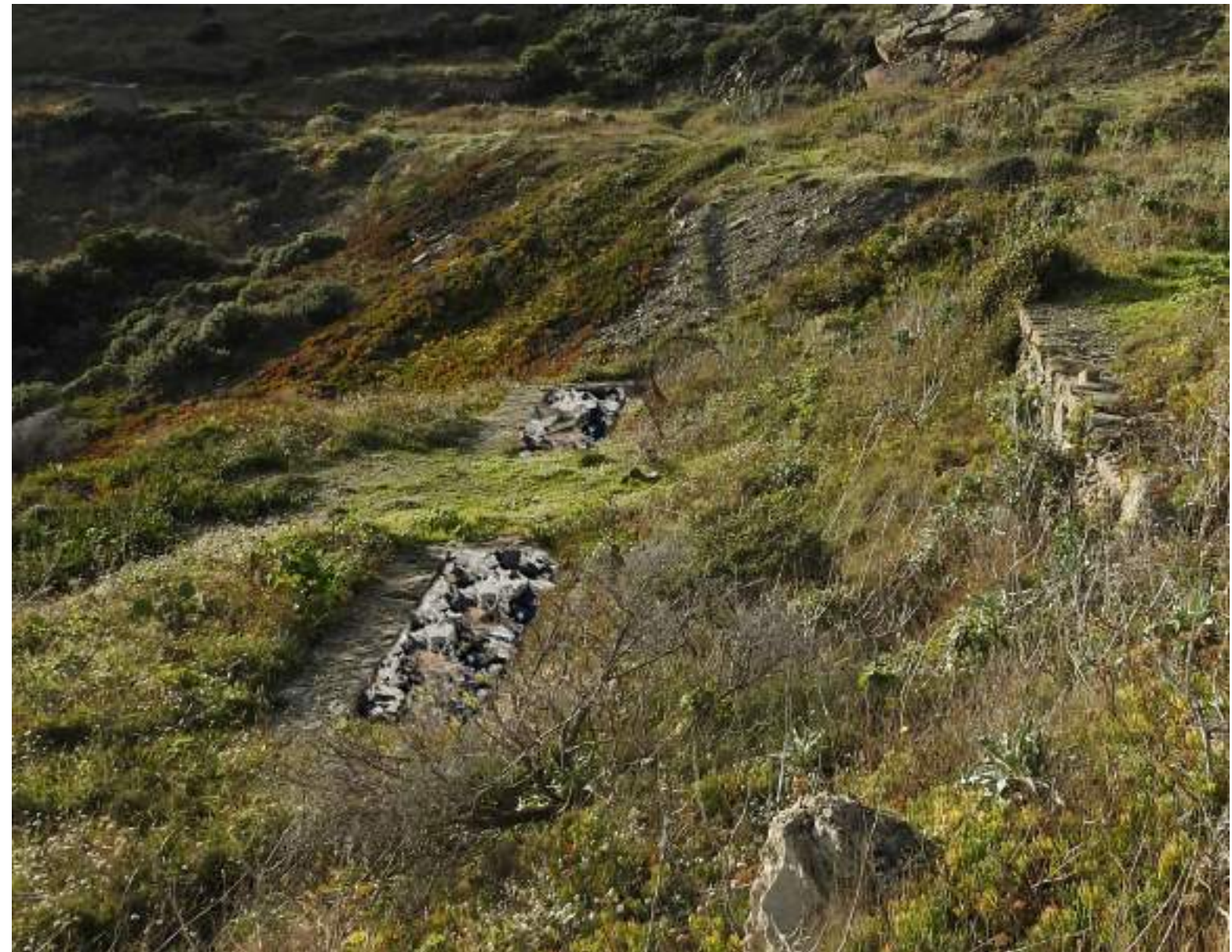
Action : Fermer l'ouvrage par le remblaiement de l'édifice avec des matériaux issus de la destruction des différents ouvrages du site (bâtiments, escalier ...) Objectif : Limiter les points de curiosité attractifs, sécuriser le site et favoriser la renaturation spontanée
